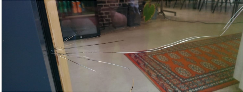
Abbildung 1: Thermisch induzierter Glasbruch bei Mehrscheibenisoliertglas.
